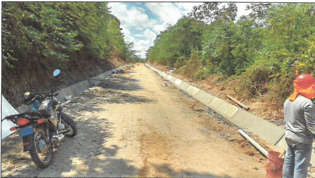
FOTO N°08: SE VISUALIZA CUNETAS EJECUTADAS EN LA IZQUIERDO Y DERECHO DE LA CARRETERA
