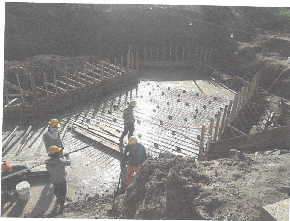
Foto N° 05.- vista se aprecia colocado de armadura para zapata del estribo izquierdo del puente cachiyacu.
