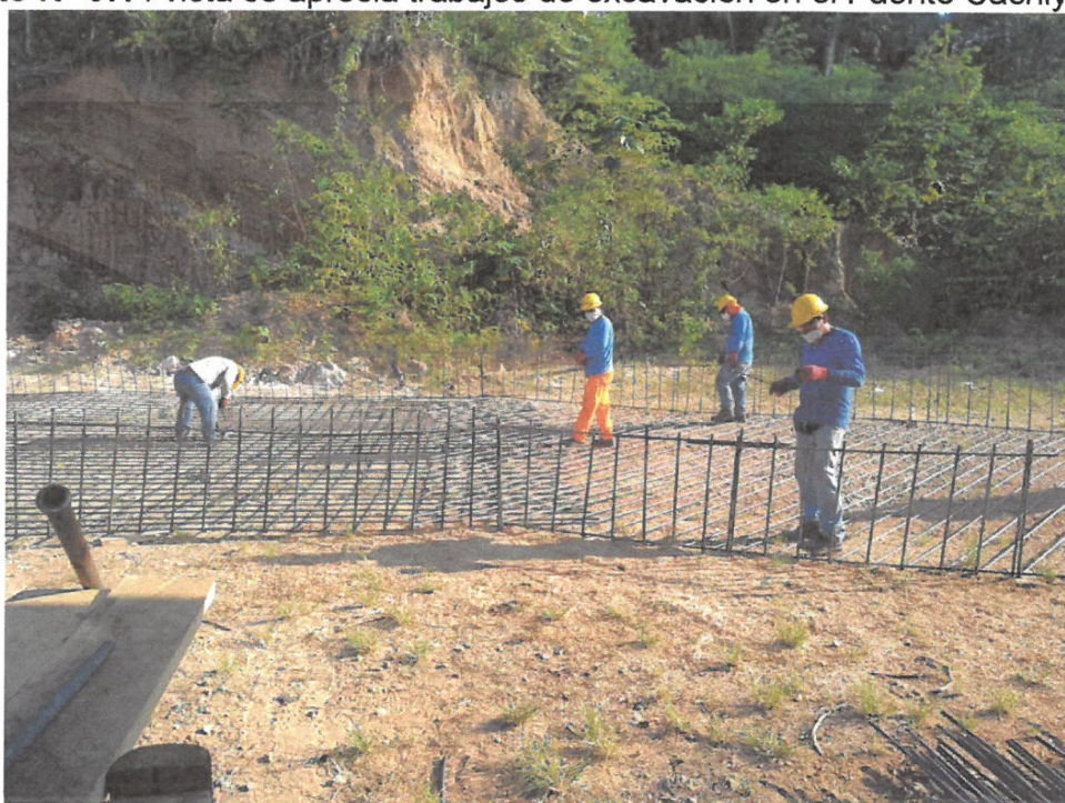
Foto N° 08.-. vista se aprecia trabajos de armado de estructura para el Puente Cachiyacu.
