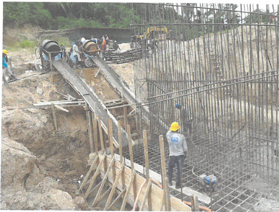
Foto N° 07.- vista se aprecia vaciado de concreto en la zapata izquierdo del puente cachiycu.
